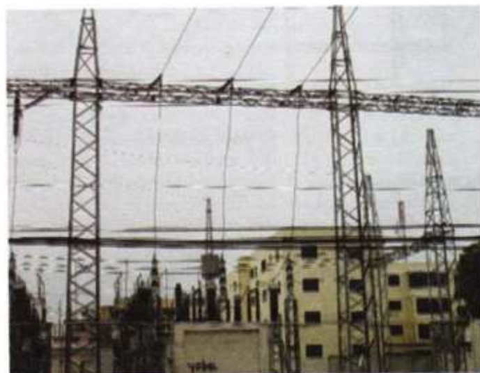
Fig. 28 Subestación de media tensión
