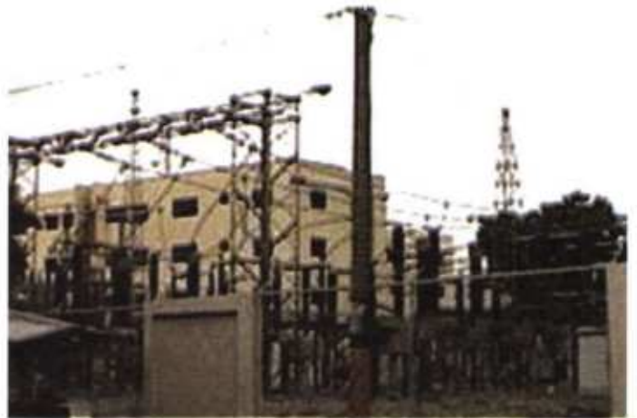
Fig. 22 Subestación eléctrica de media tensión
