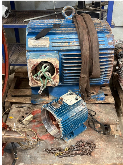
Ilustración 11. Motores eléctricos en espera de autorización del cliente.
