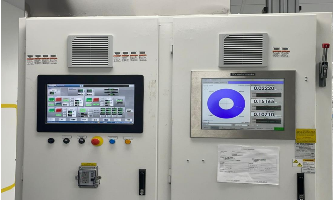
Anexo # 7 Fotografía de panel de control para el extrusor
