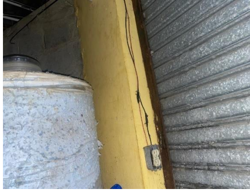
Anexo 3: Vista de cableado
