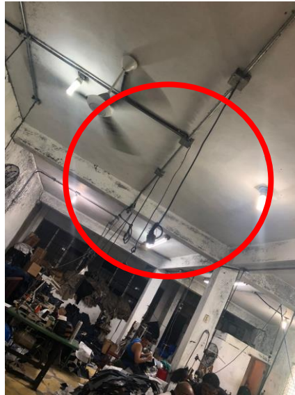
Figura 10: Cableado en área de producción
