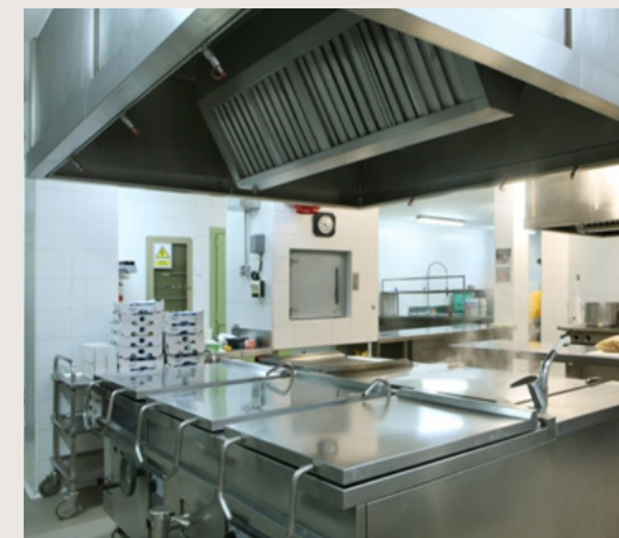
Cocina industrial con ventilación, Foto: Fuente externa.
