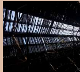
Entrada de luz accidental por deterioro
