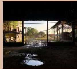
Iluminación interior deficiente, falta de entrada de luz natural
